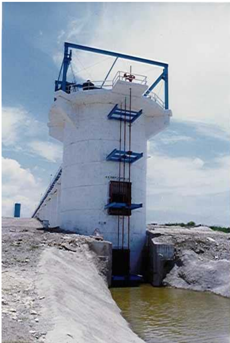
Fotografía 3.25 Obra de toma múltiple
